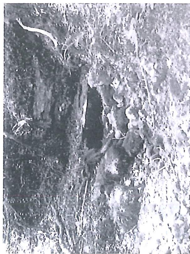
Captage de la Cabiottle Situation actuelle
