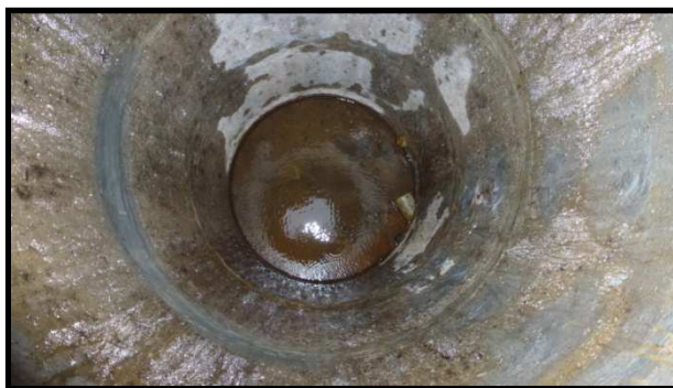
Intérieur du captage n°3
