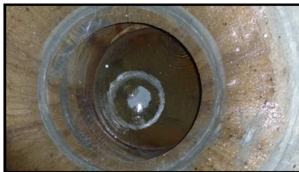
Intérieur du nouveau captage (n°1)
