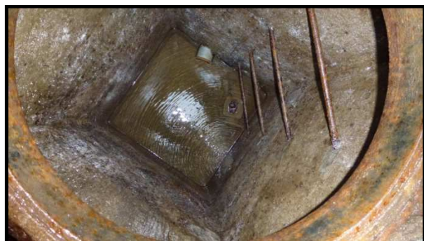
Intérieur de l'ancien captage (n°2)
