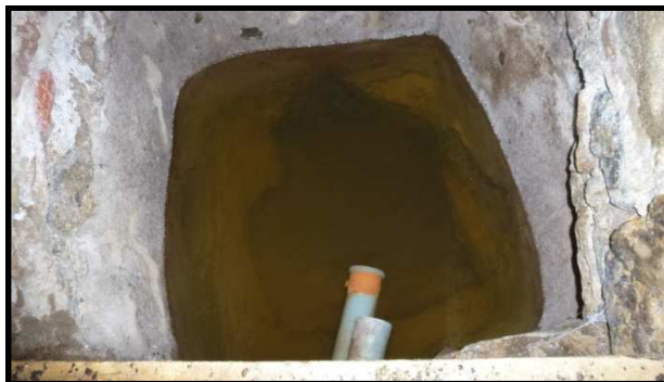
Captage de l'ancien Lavoir (déconnecté)
