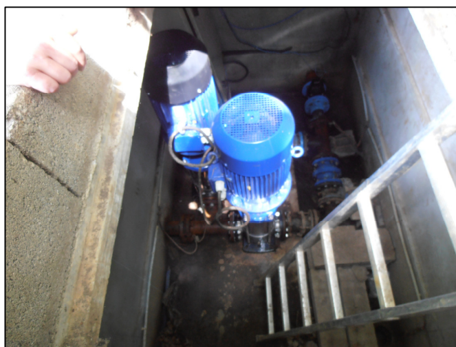
Figure 12 : le local des pompes
