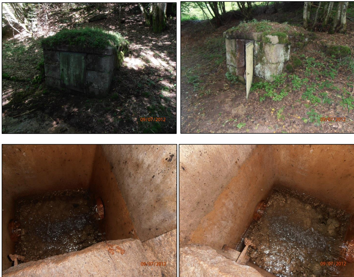
Figure 6 : la chambre de captage (ouvrage MA1) du captage du Maquet
