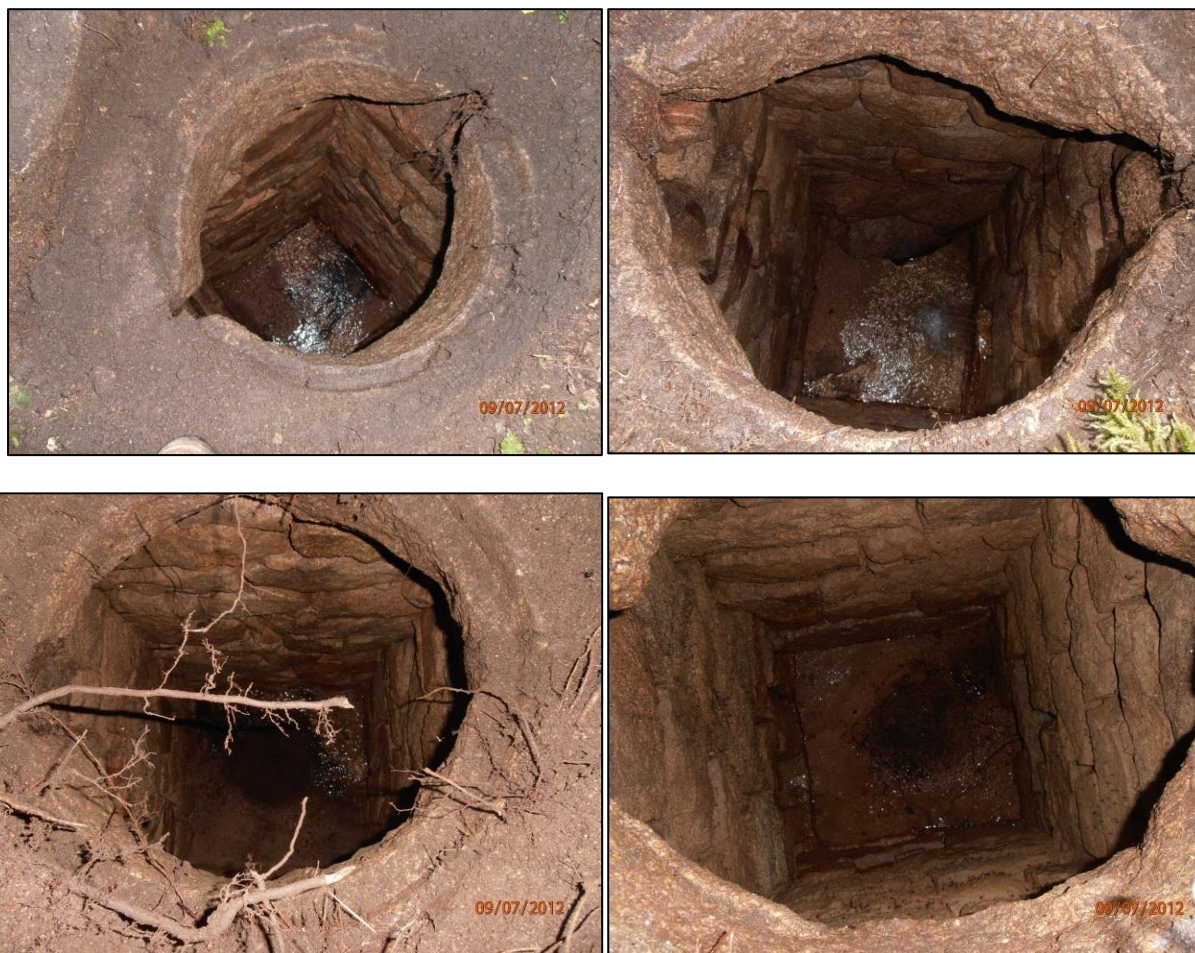
Figure 8 : regard de visite intermédiaires le long du drain du captage du Maquet
