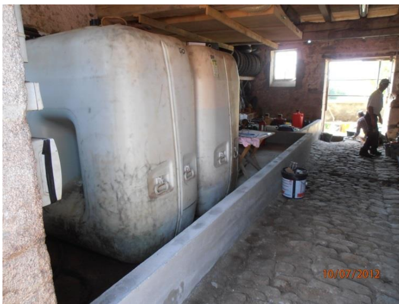
Figure 7 : cuves à fuel de la ferme des Gaudoirs
