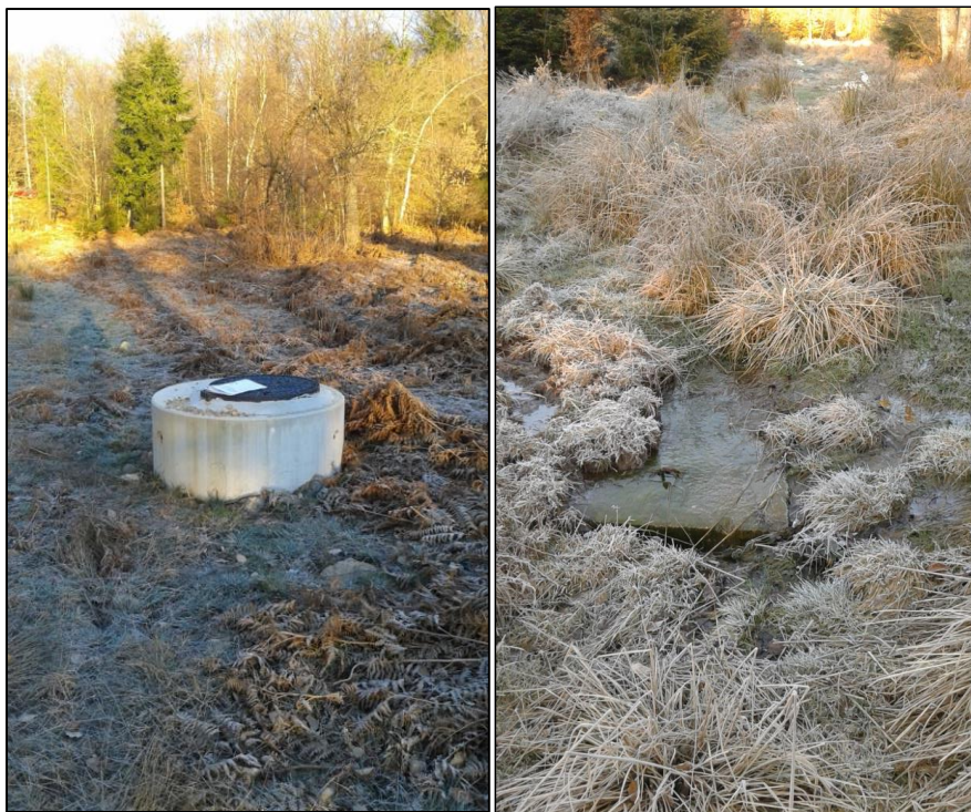
Figure 9 : le regard FE15 (à gauche) et le regard FE14 (à droite)
