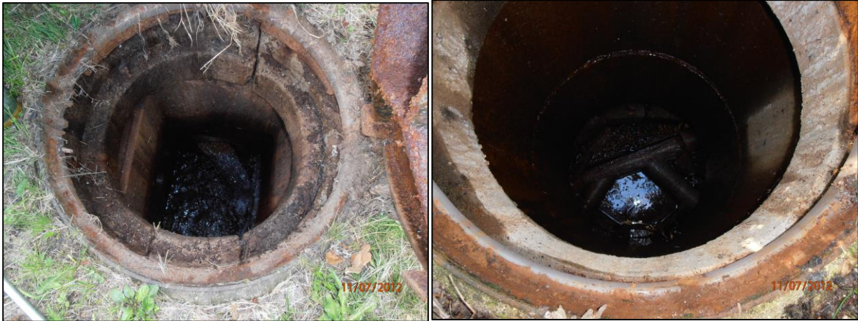
Figure 8 : regards SC1 et SC3 situés sur la conduite à l'aval de la chambre principale du captage de Source Chaude
