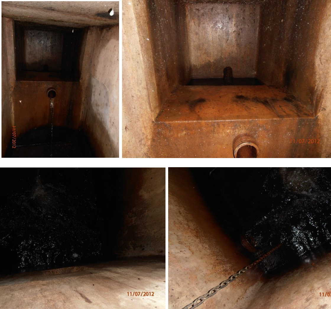
Figure 7 : l'intérieur de la chambre de réception des eaux du captage du Pouilloux
