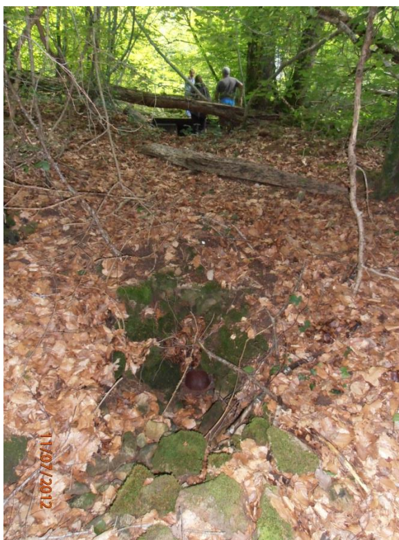
Figure 8 : le trop-plein de la chambre de réunion des Grondes
