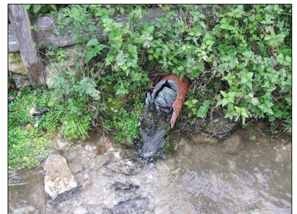
Drain type agricole à l'extrémité Sud du chemin de desserte
