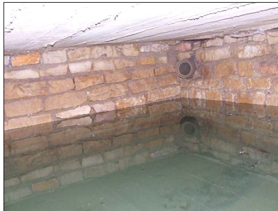
Intérieur de la bâche et départ trop-plein
