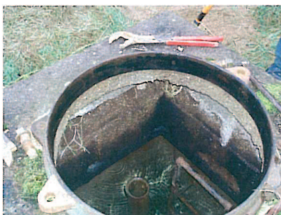
Développement de racines entre la dalle et l'ouvrage (problème d'étanchéité)
