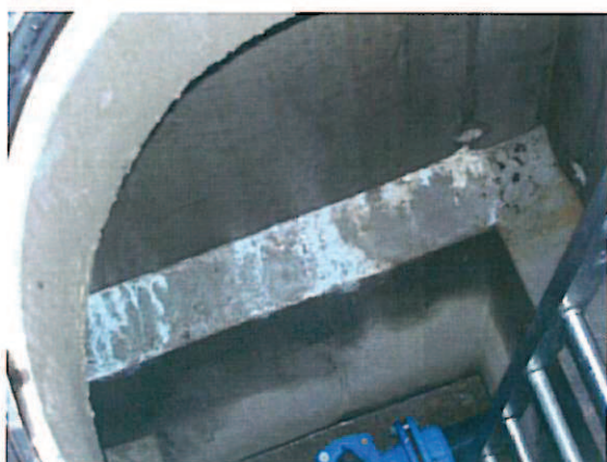
Venues d'eau parvenant dans les joints de l'ouvrage en béton
