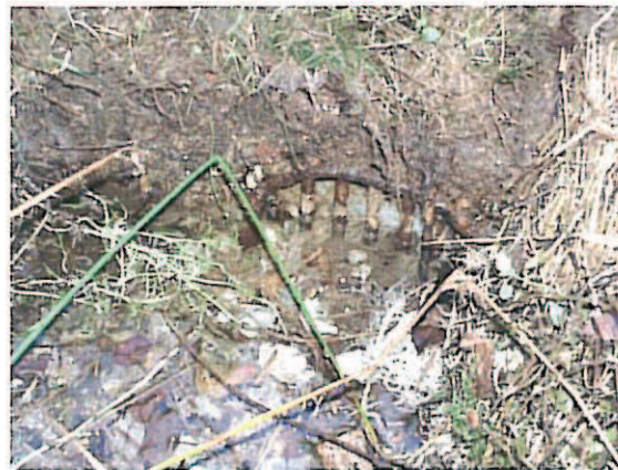
L'extrémité extérieure du trop-plein
