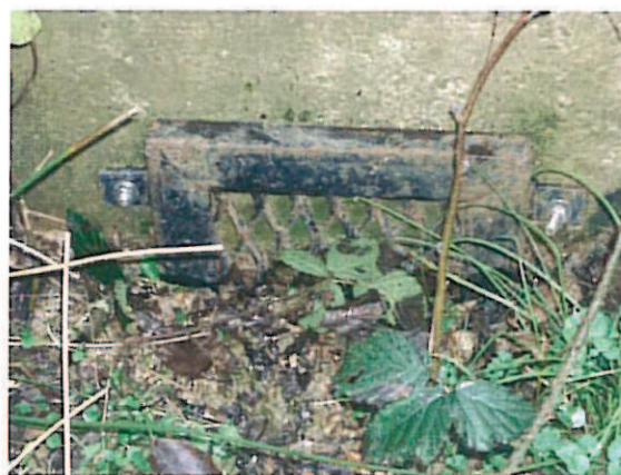
L'extrémité extérieure du trop-plein
