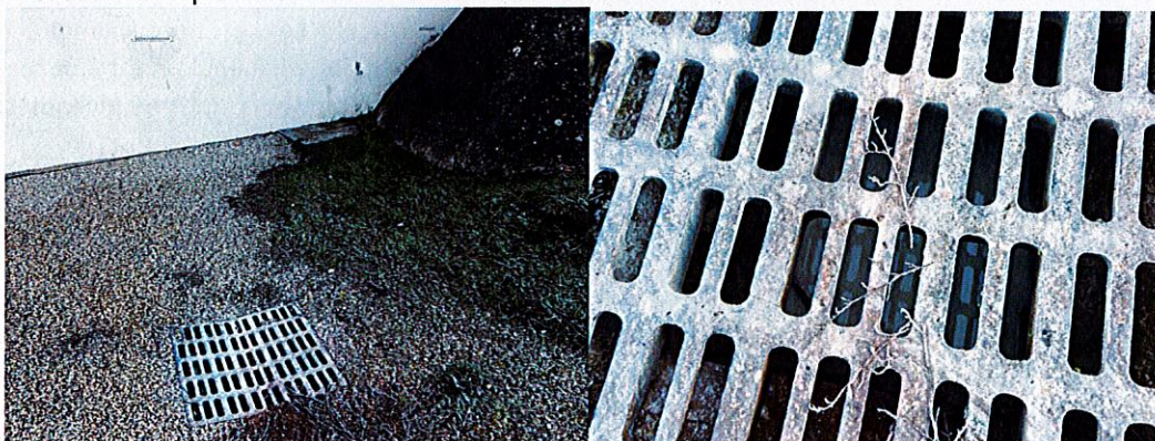
Figure 10 : Regard d'eau pluviale proche du puits
