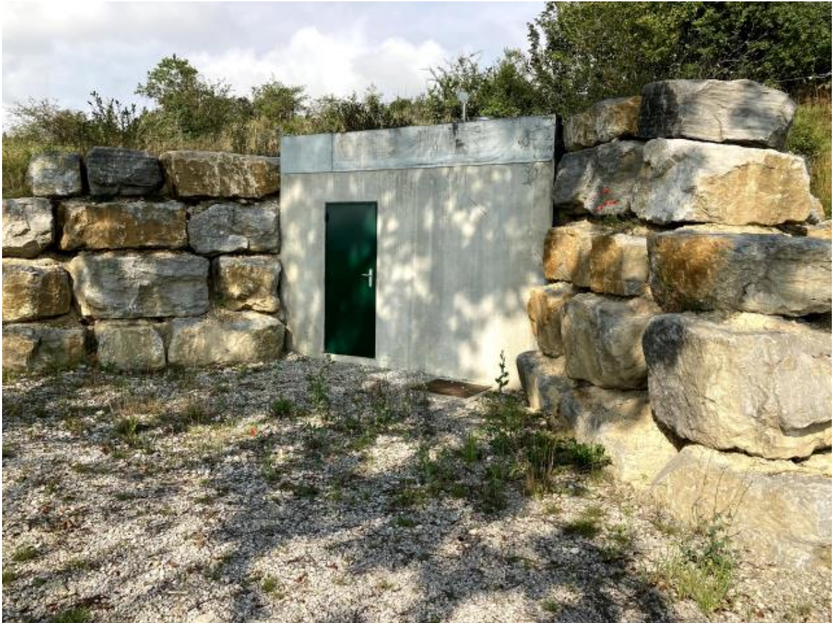
Figure 2 : Ouvrage de collecte des eaux produites par les forages des Champs Sous l'Heute
