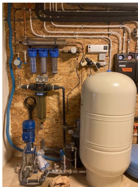
Figure 5 : Vue du local de traitement de l'eau
