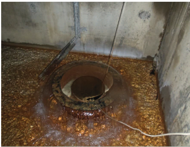
Tête du F2 avant fermeture étanche, laissant s'échapper le débit artésien. On aperçoit aussi le massif filtrant qui remonte jusqu'à la surface
