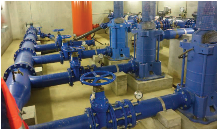
Station de reprise du BS1
