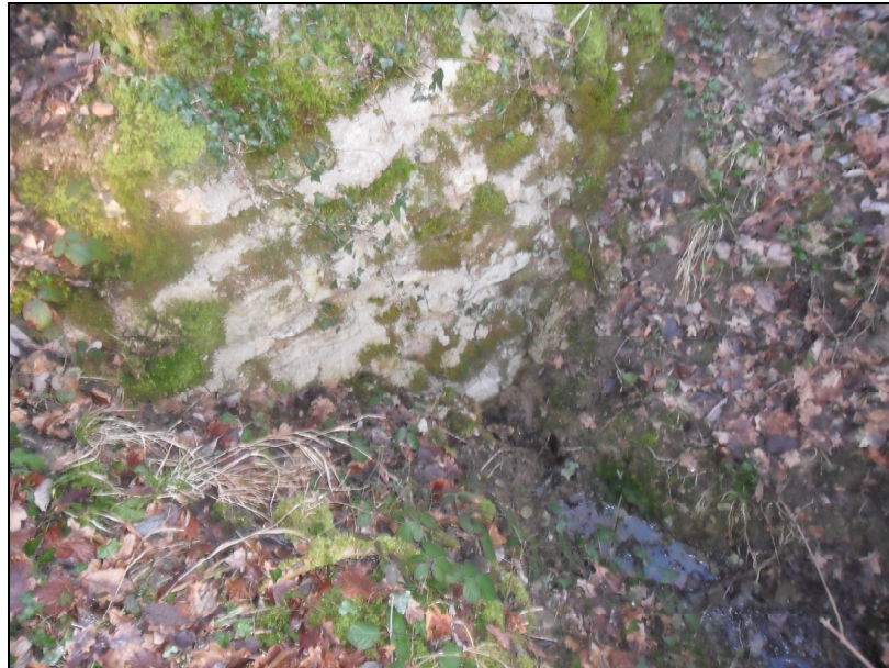
Cliché 6 : eaux de ruissellement issues du trop plein partant du captage en direction de la pente
