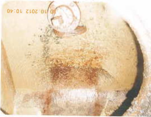
vue de la prise d'eau
